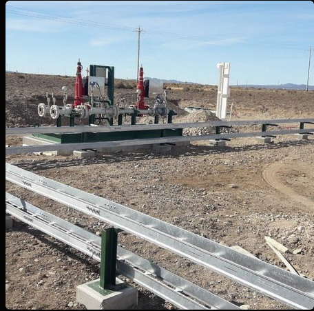
Módulo de Inyección Zona el Lago Distrito II
